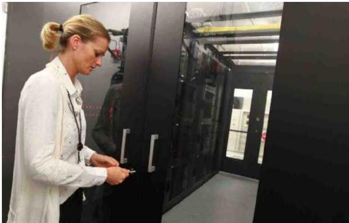
Marie-Bénédicte Viart, devant le « cœur » du Data3, une installation en ceinture-béton, avec une double porte protégeant l'accès à « la salle blanche », contrôlée par badge magnétique. PH. I. LOUVIER
